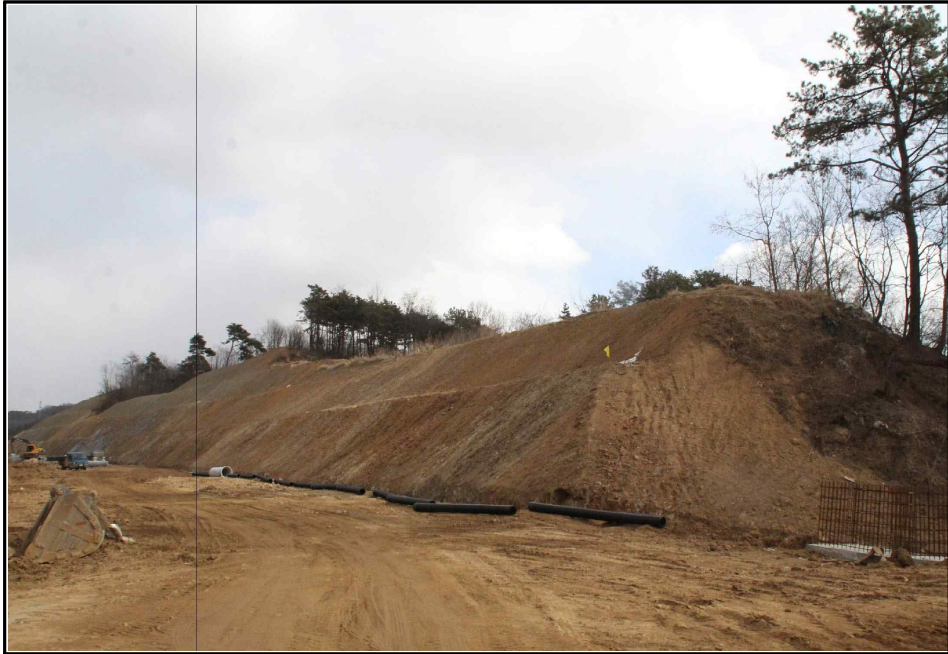
【그림 3】 깎기비탈면 시점부 측면 사진
